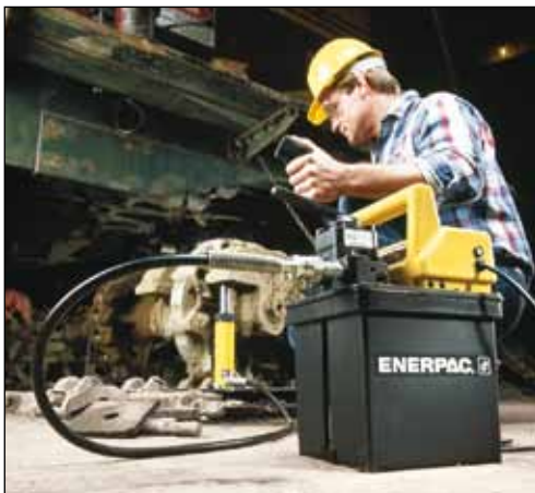
◀ El modelo de accionamiento a distancia de la bomba sumergida simplifica la reparación de esta grúa de construcción.
